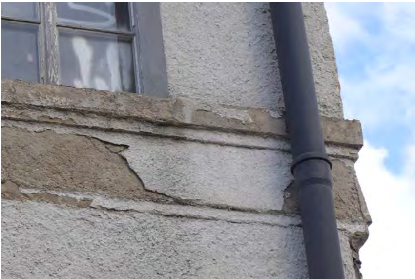
Fabrikgebäude Luxram, Putzschäden am Gesims (P1310171)
