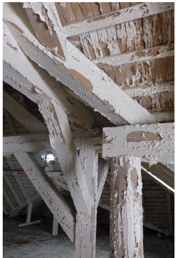
Fabrikgebäude Luxram, 2. DG Anstrich auf Holzwerk (P1300941)
