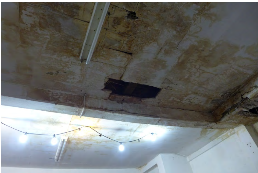
Fabrikgebäude Luxram, 1. DG Wasserschaden an Gipsdecke (P1310231)
