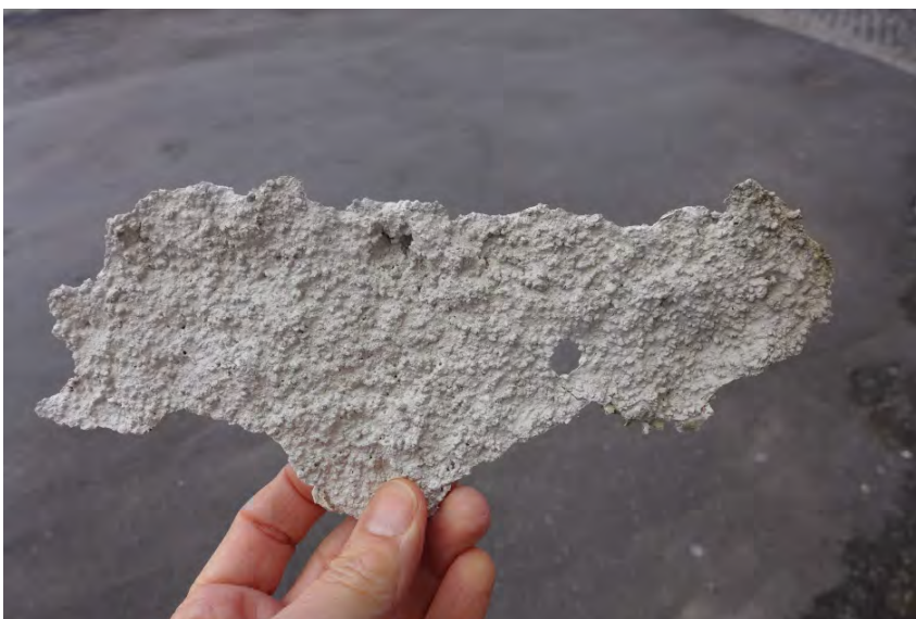
Fabrikgebäude Luxram, abblätternder Spritzputz (P1310143)
