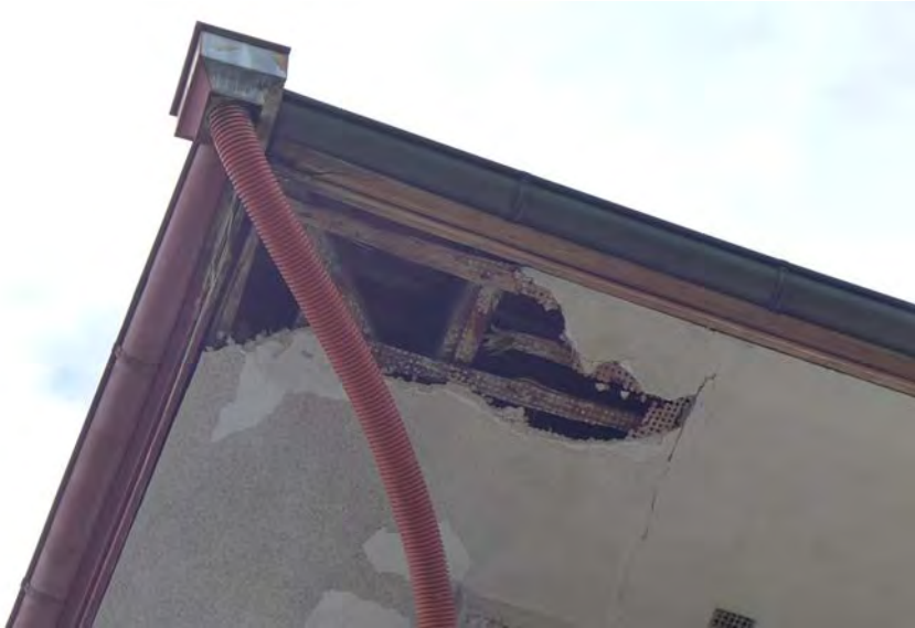
Fabrikgebäude Luxram, Schäden Dachuntersicht (P1310149)
