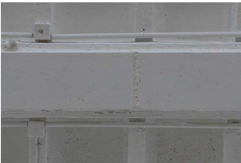
Fabrikgebäude Luxram, 2. OG Unterzug Schweissnaht (P1310263)
